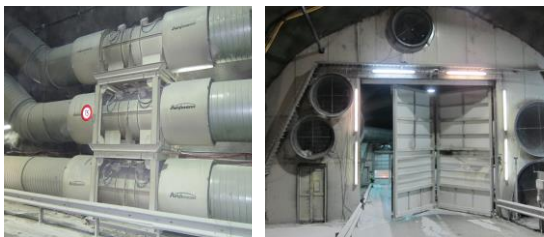
Impianto di ventilazione in cantiere e sistema di serrande nelle gallerie di accesso e ventilazione
