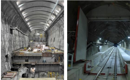
À gauche : état de la caverne abritant les machines À droite : galerie d'approvisionnement de cette caverne
