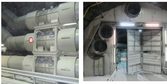
Système de ventilation et système de sas dans les galeries d'accès et galeries de ventilation
