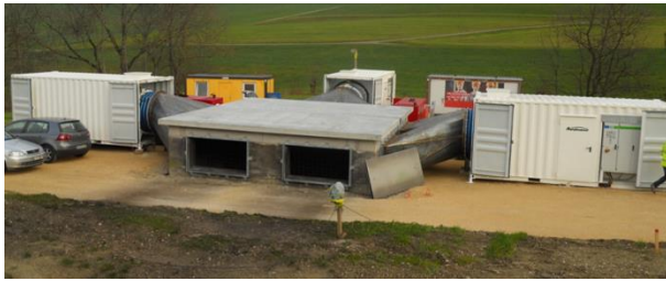
Impianto di ventilazione per il cantiere all'uscita del condotto d'aria a Zeglingen
