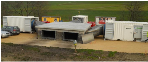
Ventilation chantier à la tête de puits de Zeglingen
