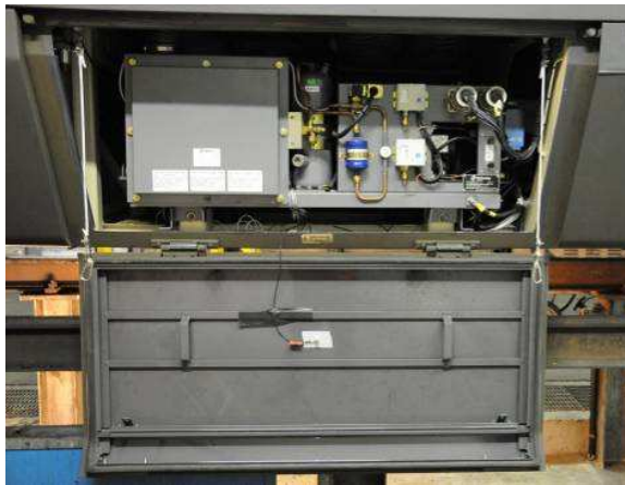
Installation d'un capteur de pression sur la partie intérieure du capot d'habillage latéral
