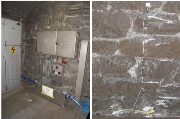
Installazione per la rilevazione di dati di misura (a sinistra) in un cunicolo trasversale nonché misuratore piezometrico di pressione (a destra) montato sulla parete della galleria
