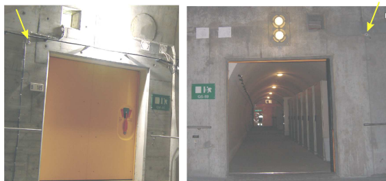
Rilevatori di pressione (freccie gialle) per registrare le oscillazioni di pressione determinate dai treni nella galleria ferroviaria
