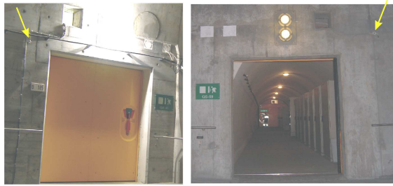
Capteur de pression (flèches jaunes) pour capter les fluctuations de pression liées aux trains dans le tunnel ferroviaire
