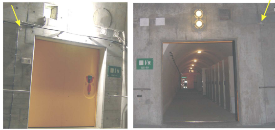
Druckaufnehmer (gelbe Pfeile) zur Erfassung der zugbedingten Druckschwankungen im Bahntunnel
