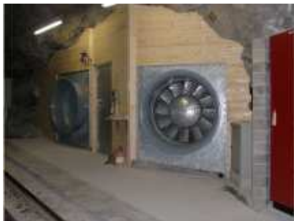
Punto di aspirazione dei ventilatori di estrazione dell'aria viziata nella galleria ferroviaria della Jungfrau
