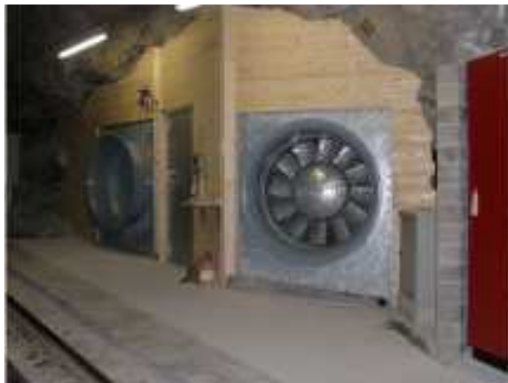
Ansaugstelle der Abluftventilatoren im Jungfraubahn-Tunnel
