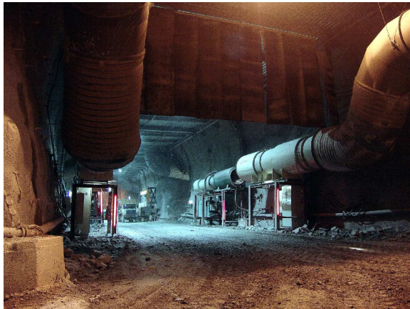
Impiego di condotte, ventilatori e macchine frigorifere per la ventilazione ed il raffreddamento in fase di costruzione
