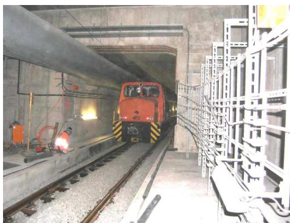
Canali di ventilazione accanto al veicolo su rotaia durante i lavori di montaggio delle infrastrutture
