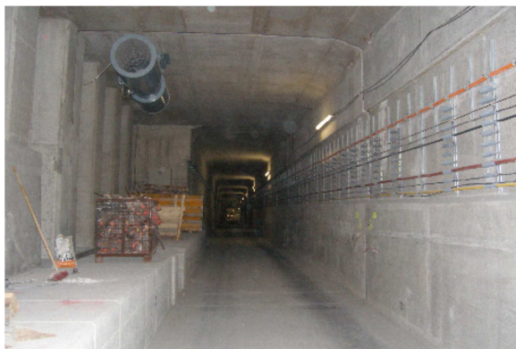
Ventilatori a getto per la ventilazione longitudinale nei tratti nelle stazioni e in galleria
