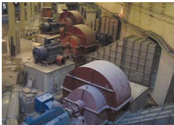
5. I nuovi ventilatori di estrazione nella centrale italiana durante la fase finale di montaggio.
