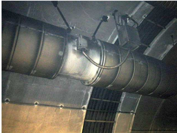
Strahlventilator vor der Sanierung
