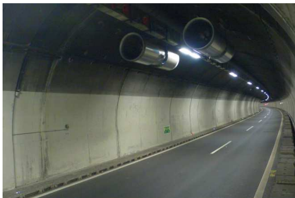
Neue Strahlventilatoren im Tunnel Piumogna
