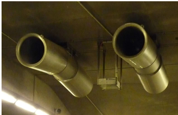
Ventilatorgruppe in der Ausfahrt zum Vogelweideplatz
