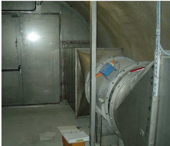
Escape tunnel fan
