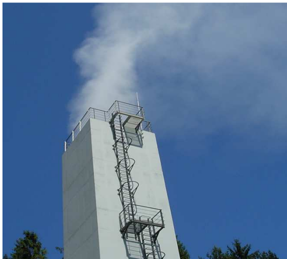
Rauchaustritt während Rauchtest
