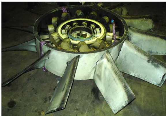
Laufrad eines Abluftventilators
