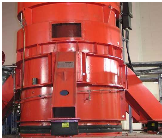
Abluftventilator A1 im Abluftbauwerk
