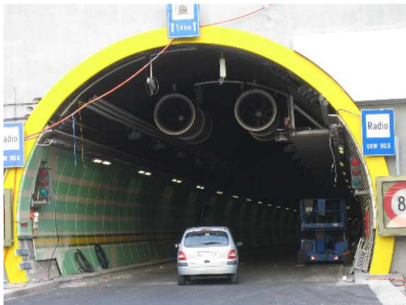
Strahlventilatoren am Nordportal der Röhre Bern/Luzern
