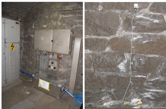
Installation zur Messdatenerfassung (links) im Querschlag sowie wandmontierter Piezo-Druckaufnehmer (rechts) im Tunnel
