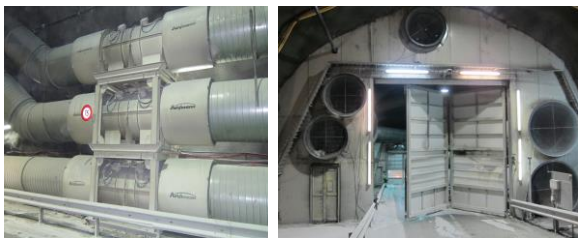
Baulüftungsanlage und Schleusensystem im Zugangs- und Lüftungsstollen
