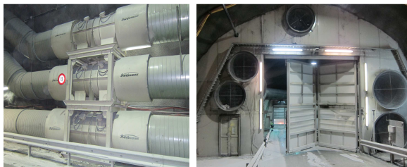
Baulüftungsanlage und Schliessensystem im Zugangs- und Lüftungsstollen
