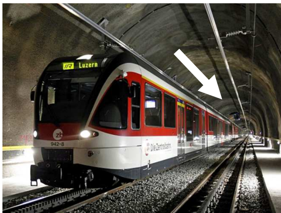
Strahlventilator der Brandnotlüftung in der Kreuzungsstelle Süd
