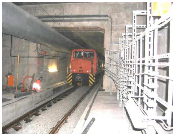
Conduit de ventilation à côté des véhicules ferroviaires pendant la phase de travaux d'équipement du tunnel
