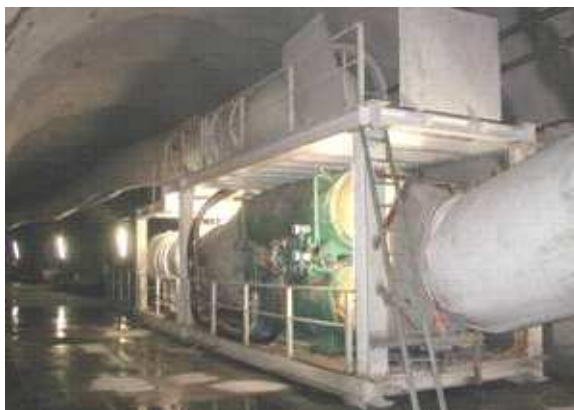
Kühlmaschine und Luftkühler
