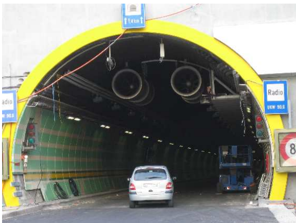
Strahlventilatoren am Nordportal der Röhre Bern/Luzern
